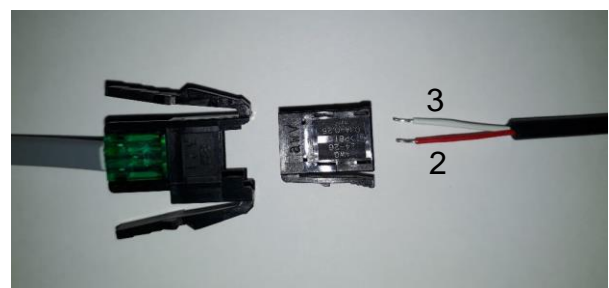
Anslutning av temperatursensorns kabel
