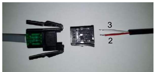
Lämpötila sensorin kaapelien kytkentä
